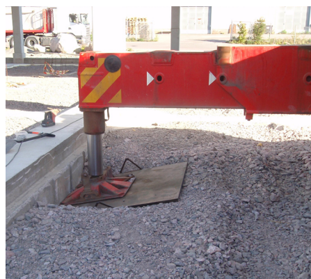
Kuva 6. Maapohjan painuminen nosturin tukijalan alla. (Kuva: Voller Oy)
