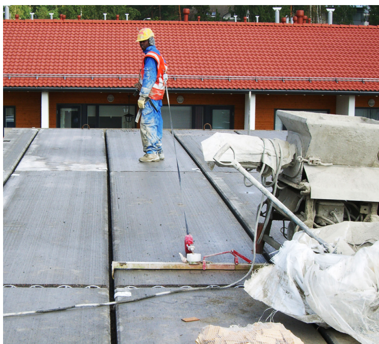
Kuva 35. Turvaljaiden kiinnityspisteeksi tarkoitettu ontelotarrain.
