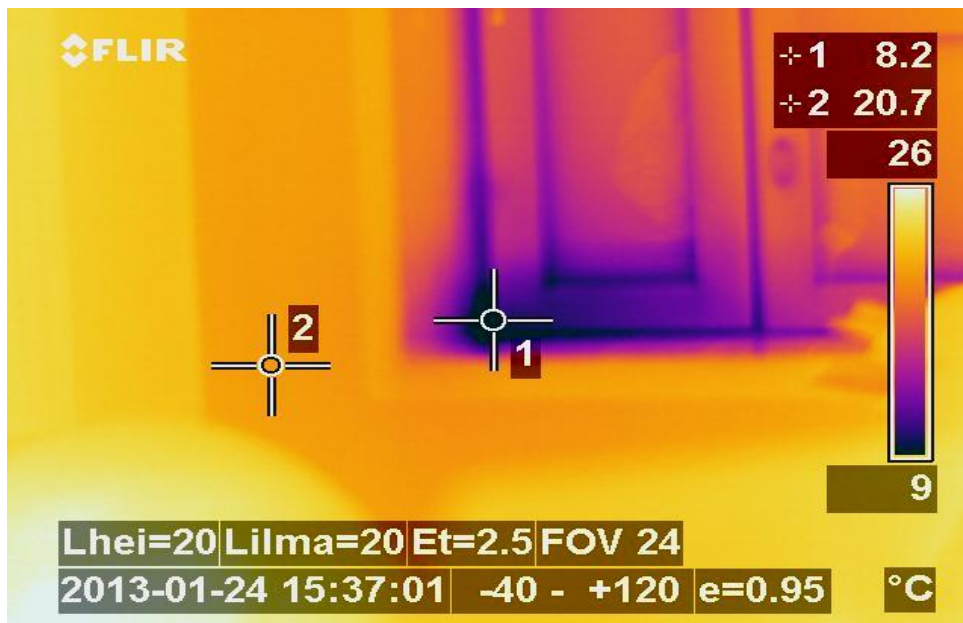
Kuvio 38. Lämpökamerakuva ikkunaliittymästä, rakennetyyppi US8.
