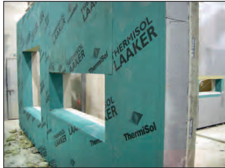
Matalaenergiatalon sisäkuorielementti 230 mm paksulla Thermisol Oy:n Platinaeristeellä. Kuva: LS-Laatusenä Oy
