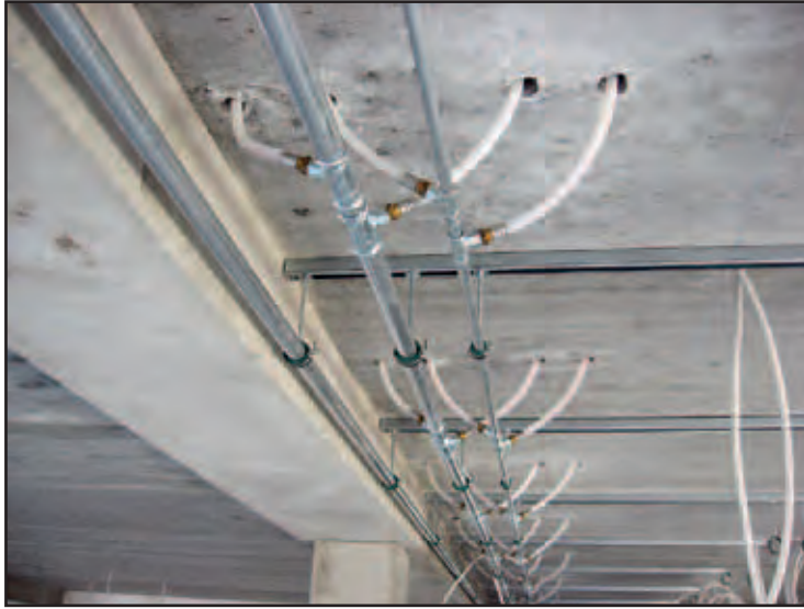
Ontelolaattavälipohjaa käytetään aktiivisesti lämmityksessä ja jäähdytyksessä. Kuvassa vesiputkisto. Kuva: ECHO.
