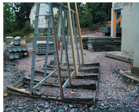
Kuva 5. Seinäelementit voidaan varastoida työmaalla myös A-pukkeihin. Elementit nostetaan A-pukeista pois vuorotellen kummaltakin puolelta, jotta telineen tasapaino säilyy.
