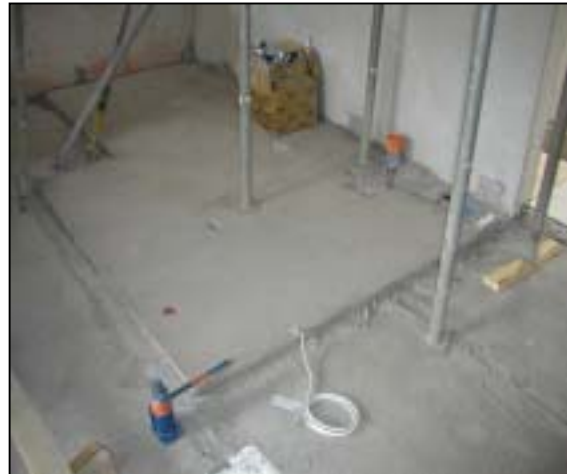
Kuva 21. Kololaatan päälle on asennettu elementtilaatta. Tehtaalla hyvissä olosuhteissa on märkätilan kallistukset ja seinän liittymät saatu tarkasti oikeisiin mittoihin. Ratkaisu on myös ääniteknisesti hyvä, koska laatta on neopreenikumien päällä.
