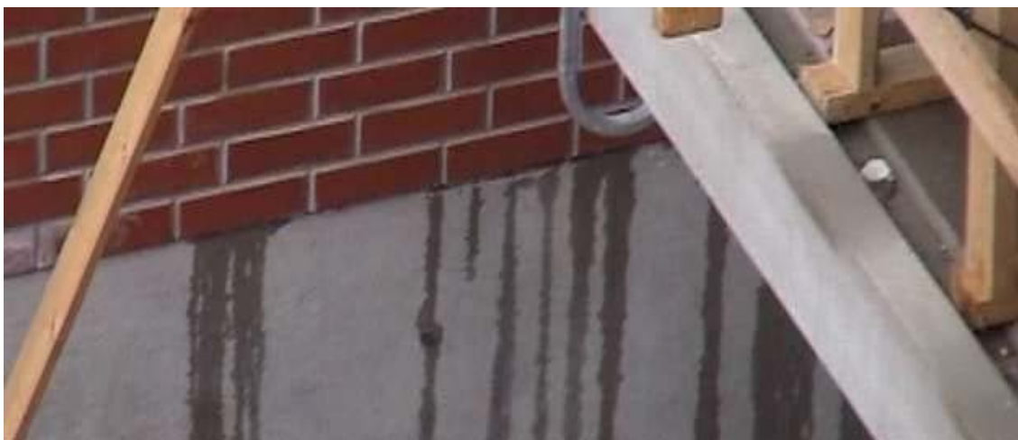
Kuva 6. Sokkelin ja perustuksen välissä ei ole toimivaa vedenpoistoreittiä. Rakennuskosteuden lisäksi rakenteita rasittavat asumisen aikana vesihöyryn tiivistyminen SW-elementin ulkokuoren sisäpintaan. Onko kuvanmukaisessa tilanteessa vaarana, että tasoite "korkkaa" sisäpuolelta?
