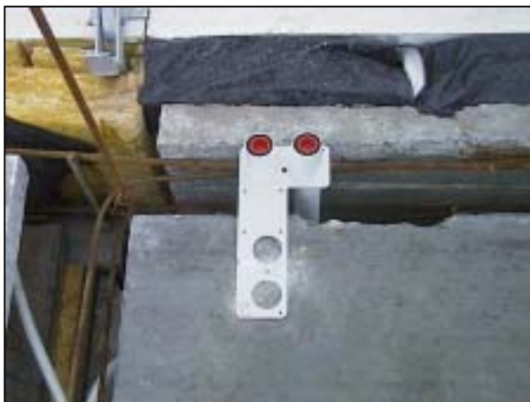
Kuva 11. Lämpöjohtonousujen läpimenokappale, joka putoaa sadevesiä saumavalun jälkeen. /Kuva Jouko Finne/.
