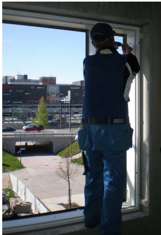
Kuva 12. Ikkunoiden asentamista tehtaalla voidaan perustella myös työturvallisuusnäkökulmalla. Ikkunoiden asentaminen työmaalla voidaan luokitella putoamisvaaralliseksi työksi.
